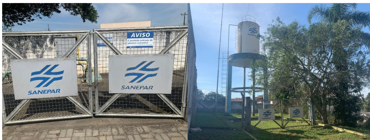
Figura 26 - Poço de Captação na Sede urbana | Reservatório em Catanduvas do Sul
